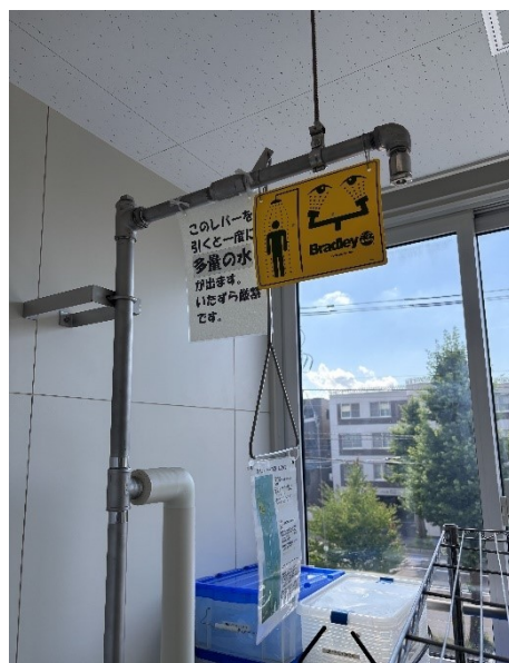
▲緊急用シャワー（エマージェンシーシャワー）
